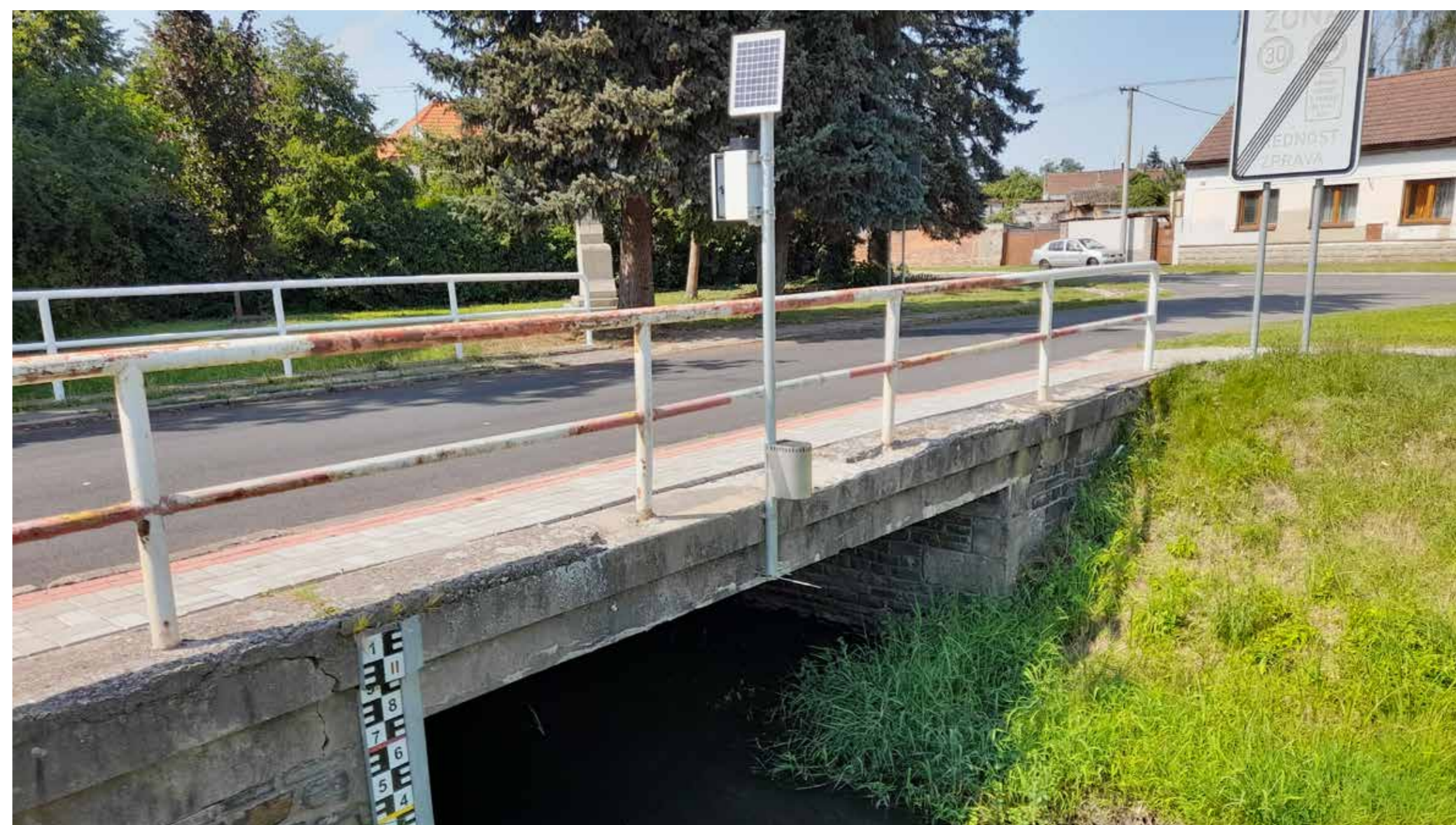
Ultrazvukové čidlo pro měření vodního stavu na Bačovce, obec Velký Osek.
